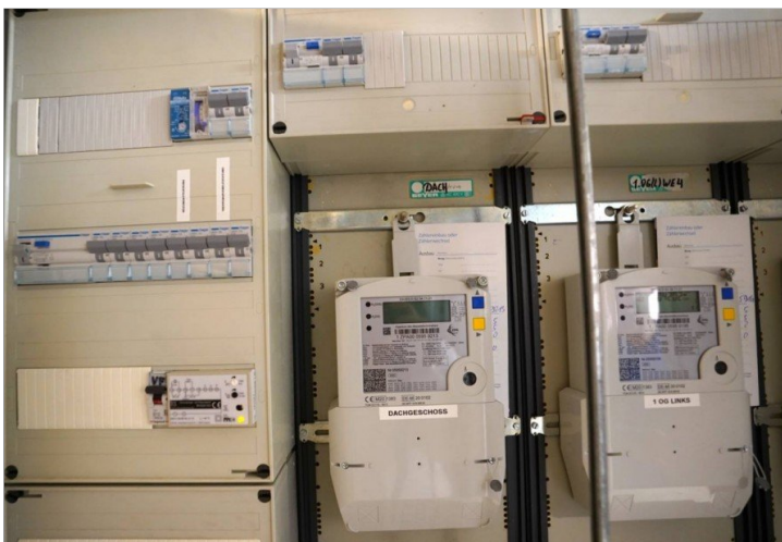
Stromzähler im Kellerbereich
